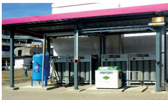
Zdjęcie: Lokalizacja instalacji pilotażowej CO 2 -SNG w TAURON Wytwarzanie S.A. Oddział Elektrownia Łaziska w Łaziskach Górnych Photo: Location of CO 2 -SNG Plant in Tauron Wytwarzanie Łaziska Power Plant
